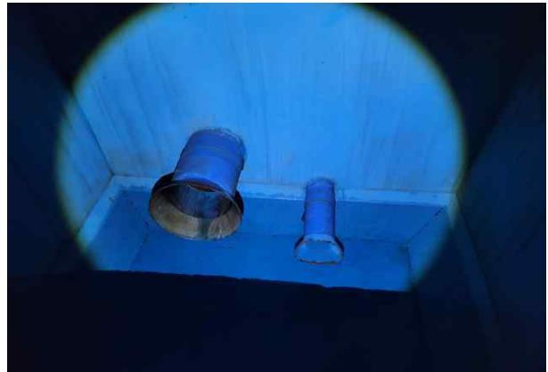
손상내용 배수지 3지 유출배관 부식 손상원인 도장열화, 수분접촉
