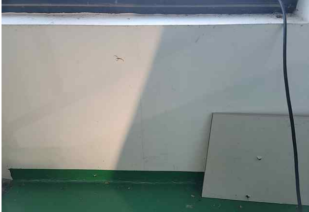
손상내용 펌프실 지상1층 벽체 망상균열 손상원인 건조수축, 온도변화
