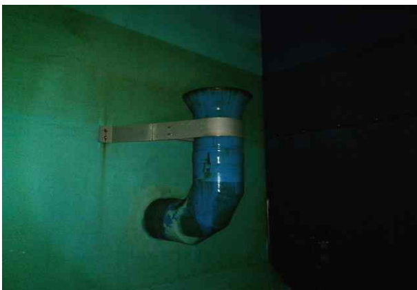
손상내용 배수지 4지 유입배관 부식 손상원인 도장열화, 수분접촉
