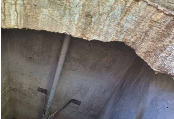
위 치 송수-1 Sta.7+6.35(이토) 손상내용 상부슬래브 콘크리트 파손
