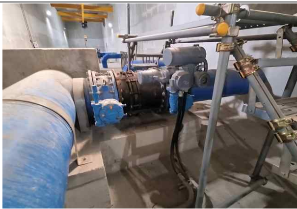
기계설비(1~2호지 밸브 및 배관)
