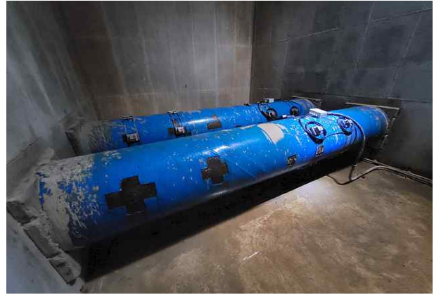
유량계실 내부 전경
