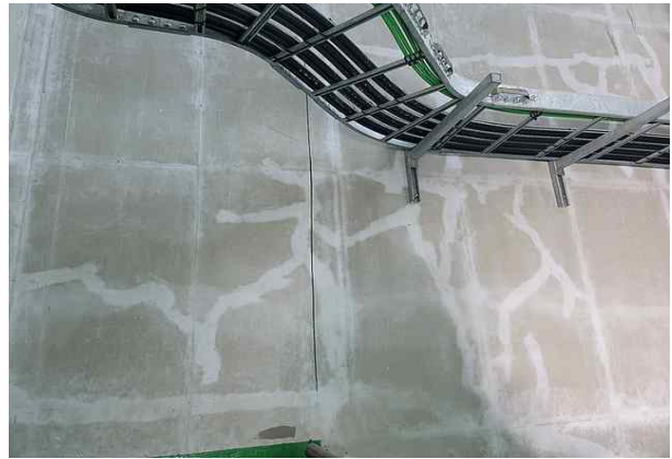
손상내용 펌프실 지하 내부벽체 망상균열 손상원인 건조수축, 온도변화
