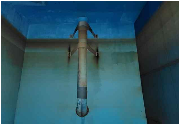
손상내용 배수지 3지 유입배관 부식 손상원인 도장열화, 수분접촉
