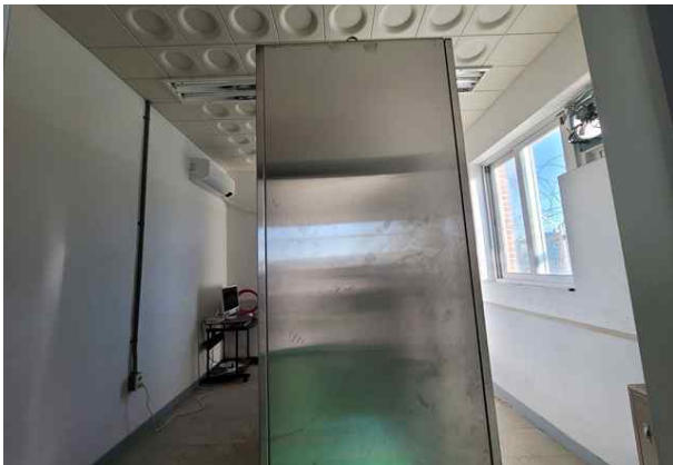
전기실 내부 전경
