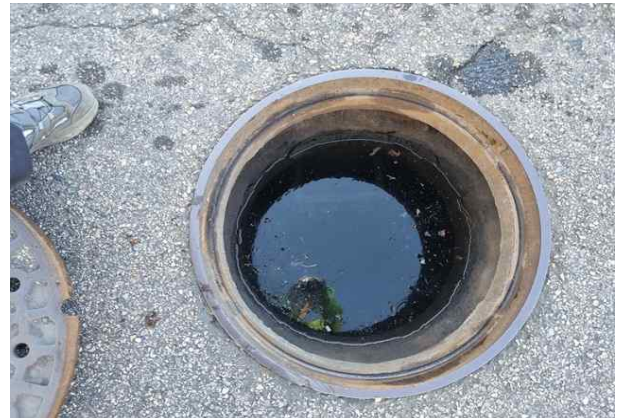
위 치 송수-2 Sta.48+45.5(공기) 손상내용 만수
