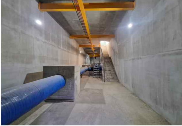
1~2호지 유입밸브실 내부 전경
