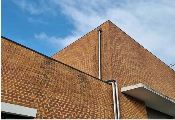
손상내용 건축물 외부 오염 손상원인 외기노출
