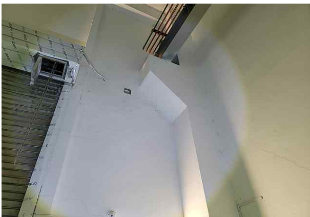
손상내용 펌프실 지상1층 벽체 균열, 누수흔적 손상원인 건조수축, 온도변화, 우수유입
