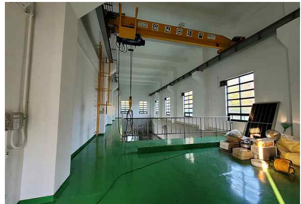
펌프실(지상) 내부 전경
