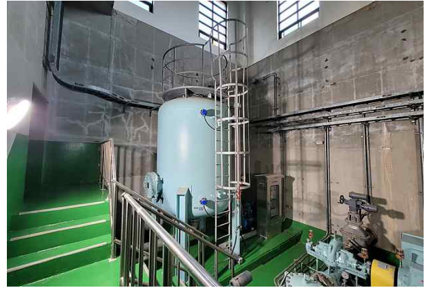
펌프실 지하 내부 전경
