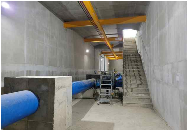
3~4호지 유입밸브실 내부 전경
