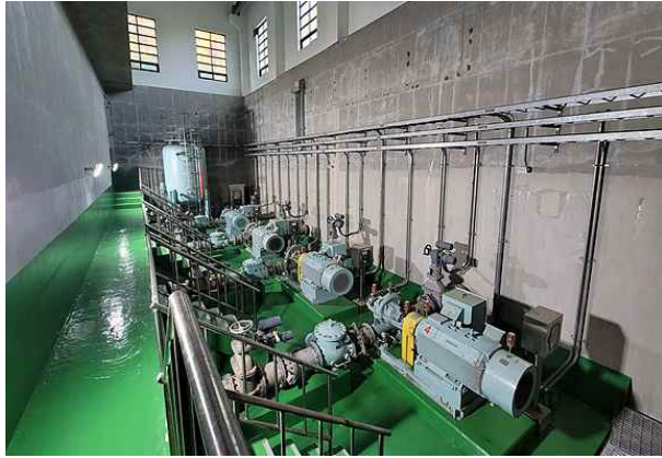
펌프실 지하 내부 전경
