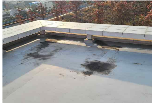
손상내용 건축물 옥상 바닥면 체수 손상원인 구배불량
