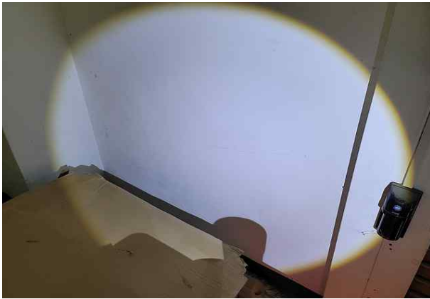
손상내용 펌프실 지상1층 벽체 물탈균열 손상원인 건조수축, 온도변화
