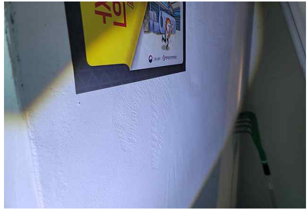
손상내용 펌프실 지상1층 벽체 물탈균열 손상원인 건조수축, 온도변화
