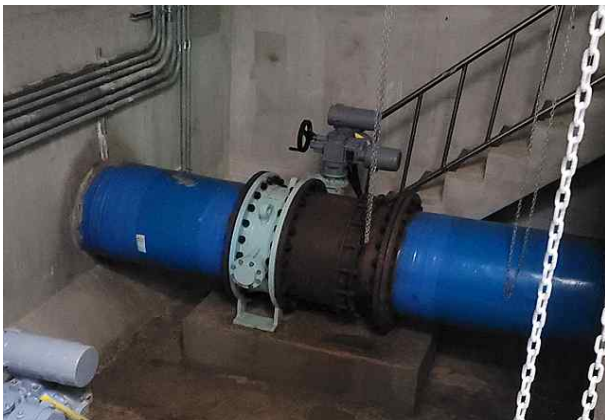
손상내용 배관실 유입밸브 상태양호 손상원인 -
