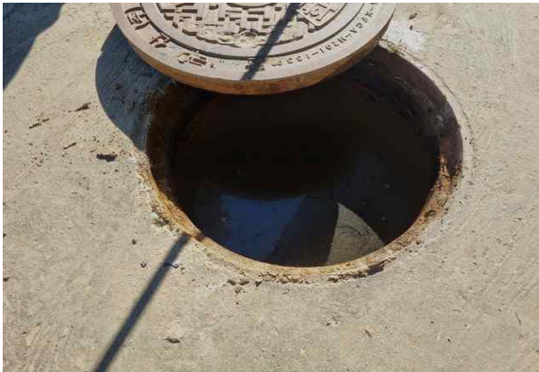
위 치 송수-2 Sta.34+13.2(이토) 손상내용 만수
