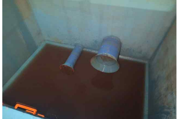
손상내용 배수지 2지 유출배관 부식 손상원인 도장열화, 수분접촉
