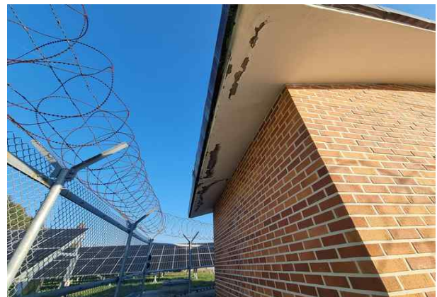
손상내용 1~2호지 검수실 외부 도장박리 손상원인 공용기간 경과, 시공미흡
