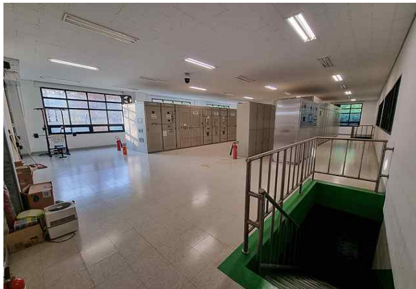
전기실 내부 전경
