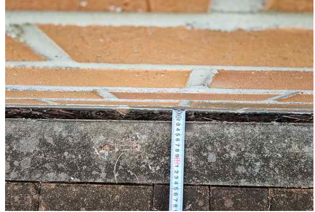
손상내용 건축물 외부 바닥 이격 손상원인 시공미흡, 외기노출
