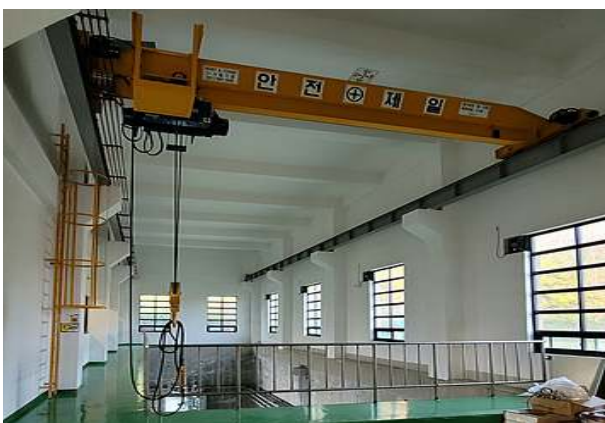
손상내용 펌프실 호이스트 상태양호 손상원인 -
