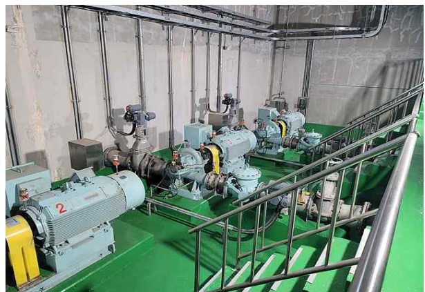
손상내용 펌프실 지하 설비 전경 손상원인 -
