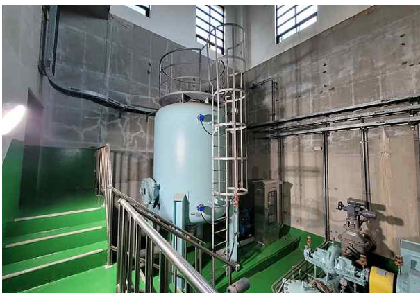
손상내용 펌프실 지하 설비 전경 손상원인 -
