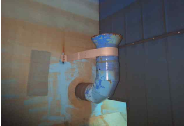
손상내용 배수지 2지 유입배관 부식 손상원인 도장열화, 수분접촉
