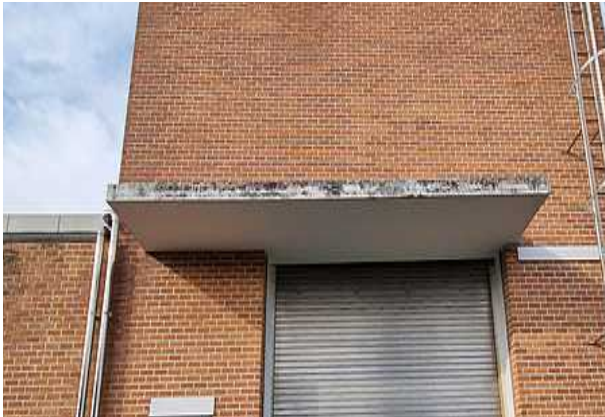
손상내용 건축물 외부 캐노피 도장박리 손상원인 시공미흡, 공용기간 경과
