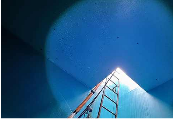
손상내용 1지 상부슬래브 균열/백태 손상원인 미세균열부 수분침투
