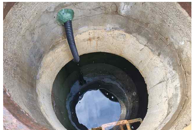
위 치 송수-3 Sta.0+14.7(공기) 손상내용 만수
