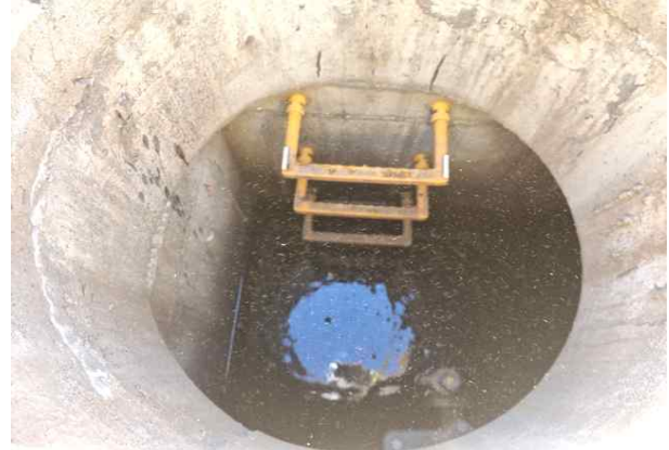
위 치 송수-1 Sta.48+15.0(공기) 손상내용 밸브실 침수(H=0.3m)
